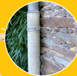
descente eaux pluviales/ eaux usées
